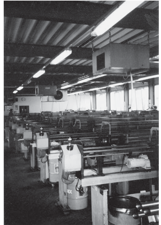
Décolletage-Werkstatt mit künstlicher Raumlüftung. Die Luft wird nach der Filtration wieder in den Arbeitsplatzbereich zurückgeführt.
